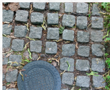
существующие дорожки из гранитной брусчатки, находящиеся в неудовлетворительном состоянии, необходимо укрепить бортовым камнем
